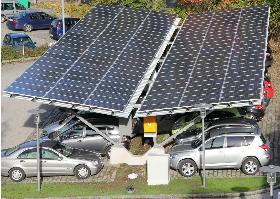
Die neuen Solar-Carports mit Photovoltaikmodulen aus der Sicht vom Dach des Sparkassen-Centers, das nun stromautark versorgt wird.
